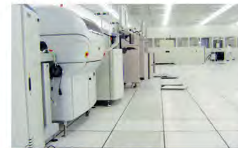
Control center 控制中心
